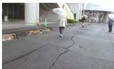
益城町総合体育館前（地盤沈下と液状化現象）
